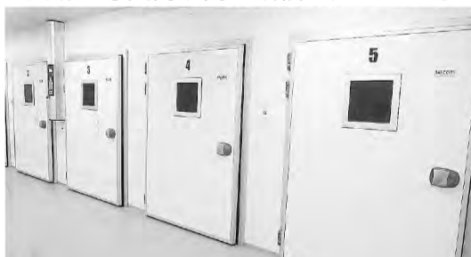
【写真6】「ラミネーエアフロー」技術搭載のチックストレージールーム
